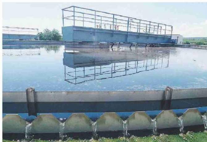
AQP La vasca del depuratore di Gallipoli
